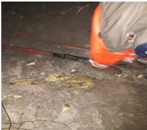
Figura 3. Identificarea defectului de manșon pe porțiunea cu steril solidificat
