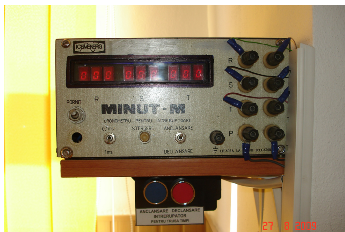
Fig.4. Dispozitiv de înregistrare a timpilor de acționare la întrerupătorul de cuplă Longitudinală Fig.4. Time recording device to switch the coupling actuator longitudinal
