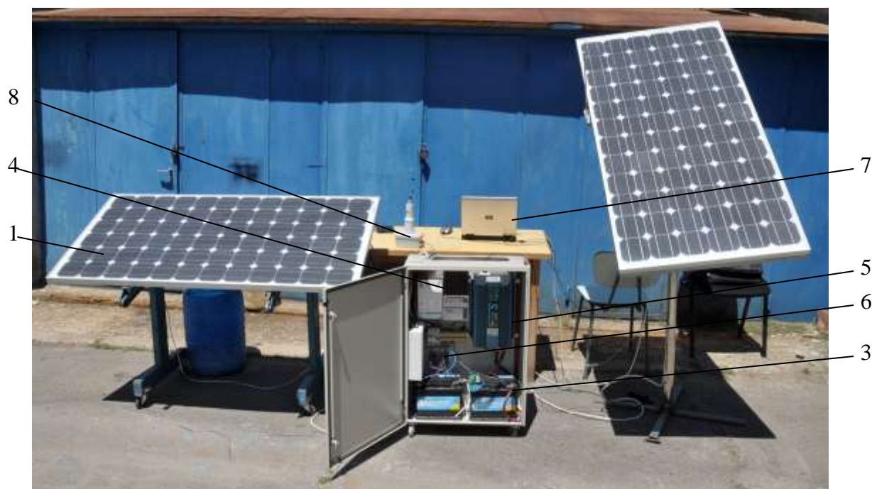
Figura 5 Elementele componente ale instalației solare
