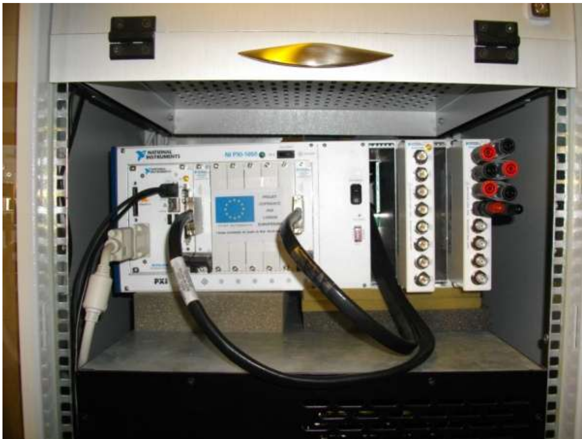
Figura 4. Sistem de achiziție și comandă NI PXI (PCI eXtensions for Instrumentation) Figure 4. Acquisition and control system NI PXI (PCI extensions for Instrumentation)
