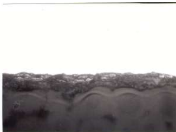
Imaginea 6. Coroziune uniformă Picture 6. Uniform corrosion
